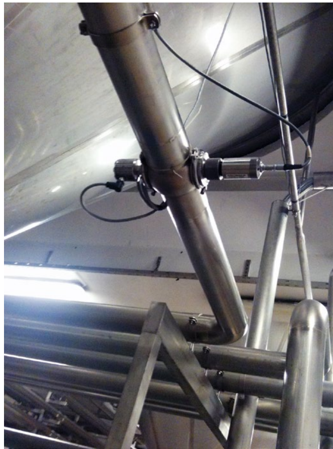
Fig 3. Senzor Hach M1100-H LDO – instalare tipică
